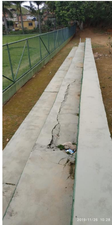
Figura 3- Vista de ponto deteriorado.
