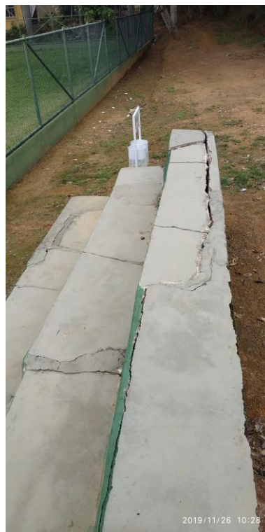
Figura 4 - Vista de pontos deteriorados.
